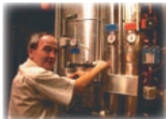
Unser Haustechniker Hermann Dürnberger bei der Überprüfung der Heizungsanlage.
